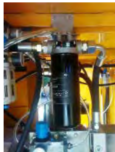
Instalación de A.P. a granel - Protección para filtros de alta presión
